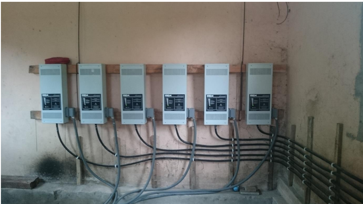
Lastregler der Firma IREM mit je 10kW Regelleistung
