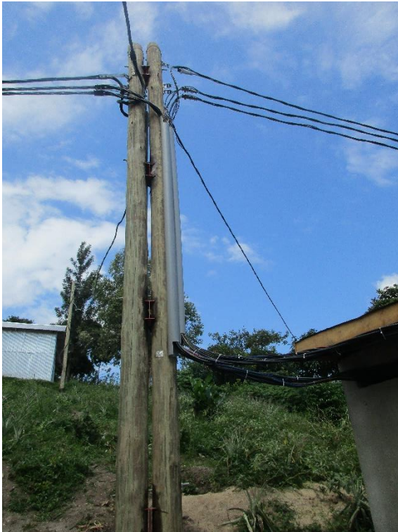
Abspannmast an der Verteilstation
