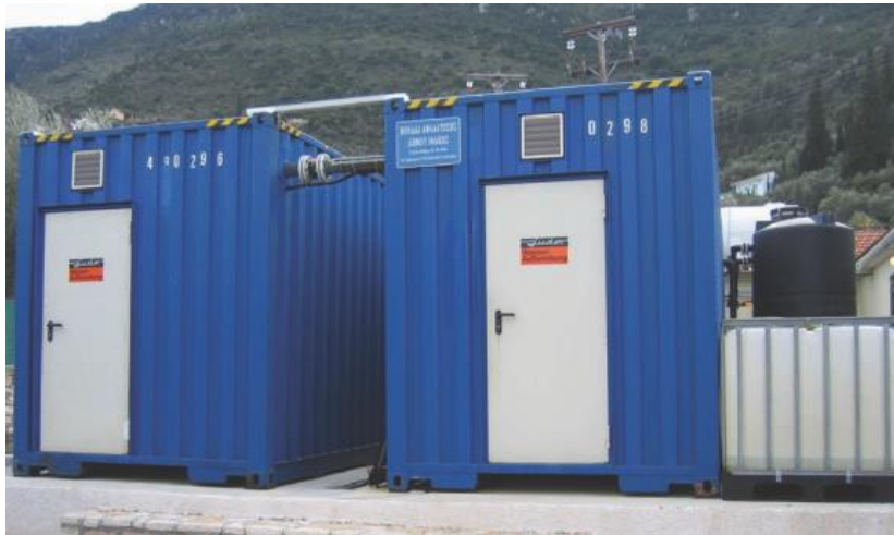
Abbildung 3: Meerwasserentsalzungsanlage in Containerbauweise in Vathi (JUDO, o. J.)
